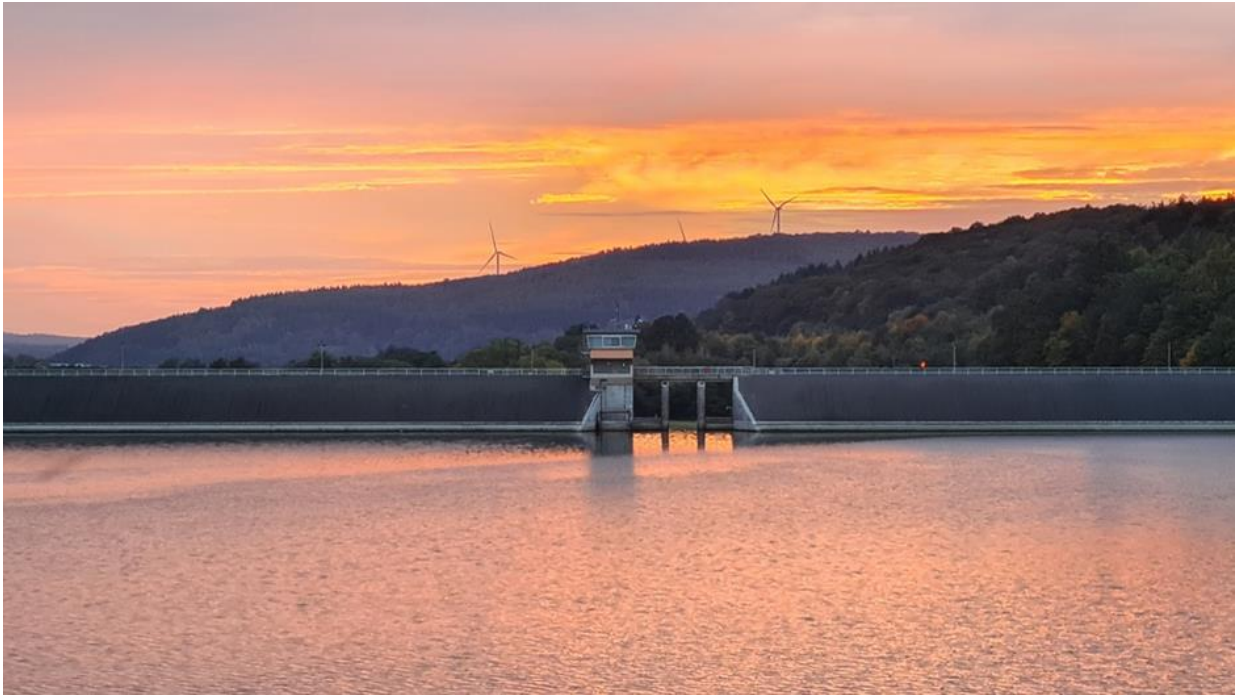
Ansicht 28: Kinzigtalsperre, Grundablass und Überwachungseinheit, eigene Aufnahme, 17. Oktober 2024
