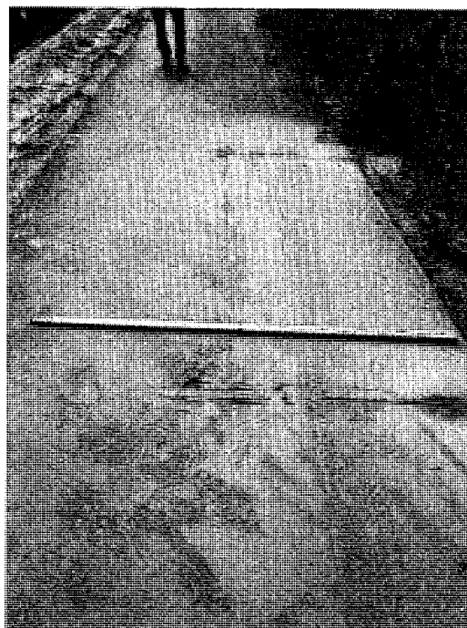
Bild 2: Riss bei Station 1050
