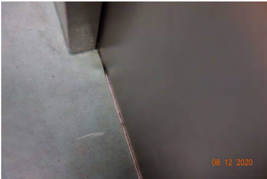
Abbildung 23 Sanierungsbedarf Bodenbelag vor Aufzug
