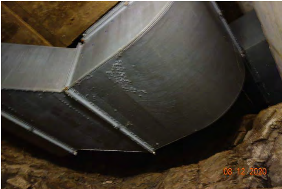
Abbildung 32: Die Lüftungstechnik sitzt teils im Außenbereich an der Felswand, inwieweit die F-90-Schottung beim Eintritt durch das Gebäude gewährleistet ist, konnte nicht erkannt werden
