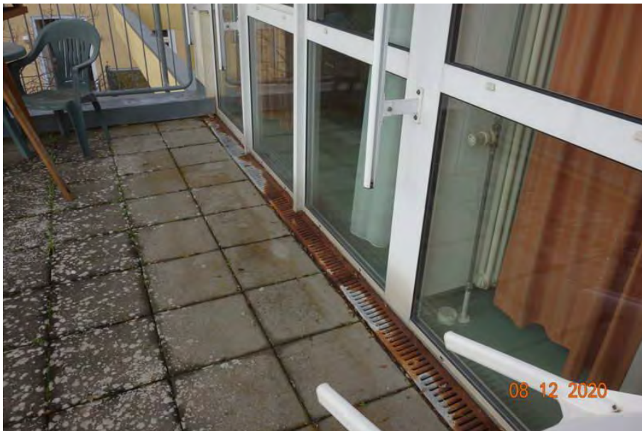
Abbildung 21: Ansicht Balkon- Sanierungsbedarf
