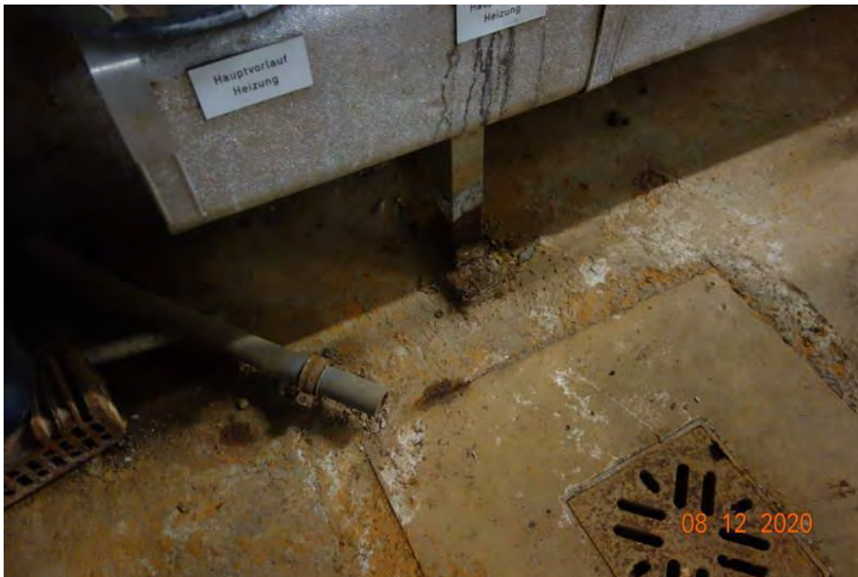
Abbildung 33: Hausanschluss- und Übergaberaum im Untergeschoss
