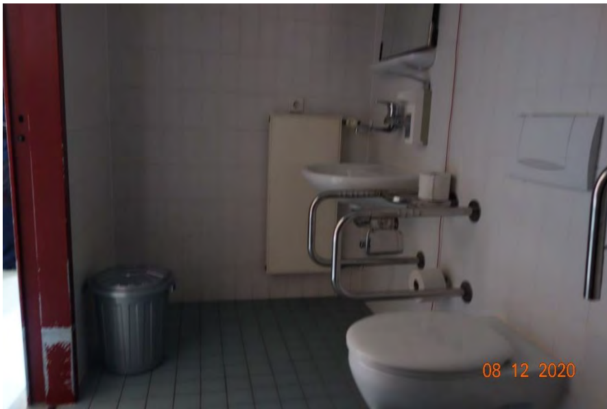
Abbildung 17: Fertignasszelle von 1980 - nicht DIN 18040-2 gerecht
