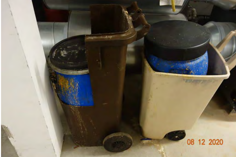
Abbildung 31 Entsorgung Fettabscheider- unzumutbare Situation für Mitarbeiter
