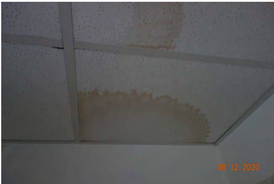
Abbildung 22 Wassereintritt an Decke
