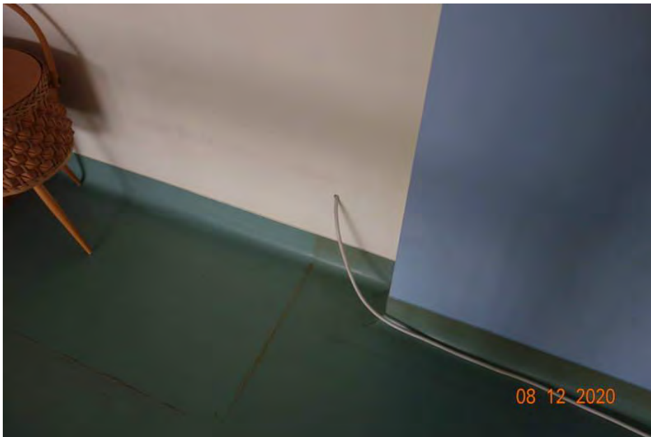
Abbildung 25 Sanierungsbedarf Bodenbelag - lose E-Installierung
