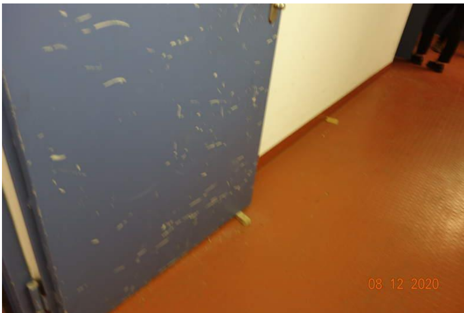
Abbildung 26 Sanierungsbedarf Stahltür - Offenhaltung mit Holzkeil
