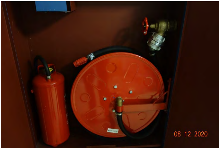
Abbildung 10: Nassleitung für Feuerwehr - Trennstation?
