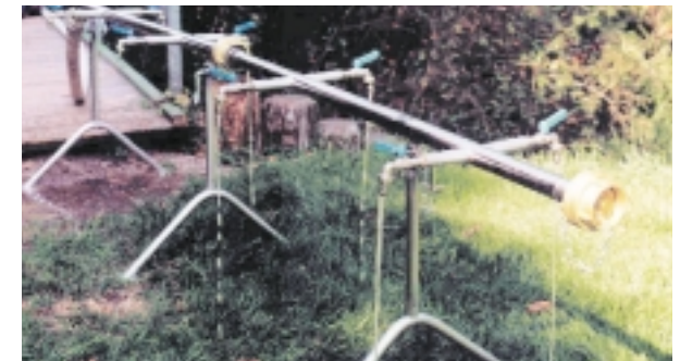
Wasserverteilung im Notfall -Beispiel einer mobilen Gruppenzapfstelle
